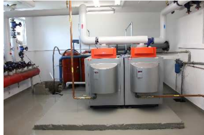
Moderne Brennwertanlage (Beispielfoto)
